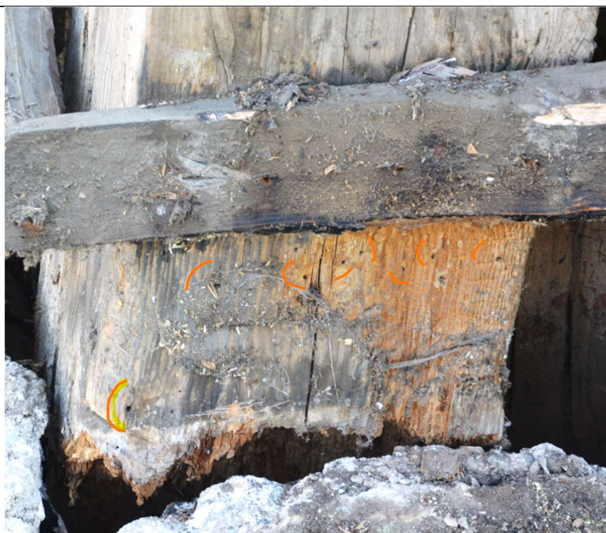
Fot. 3 Wyloty chodników w obrębie nadpsutego drewna
