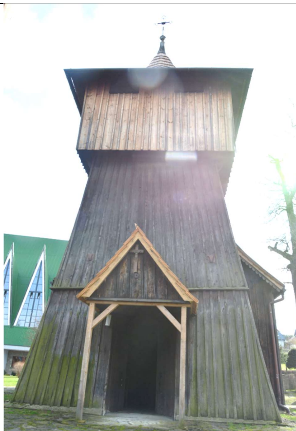
Fot. 4 Front dzwonnicy, widoczne przekoszenie w stronę płn (lewo)
