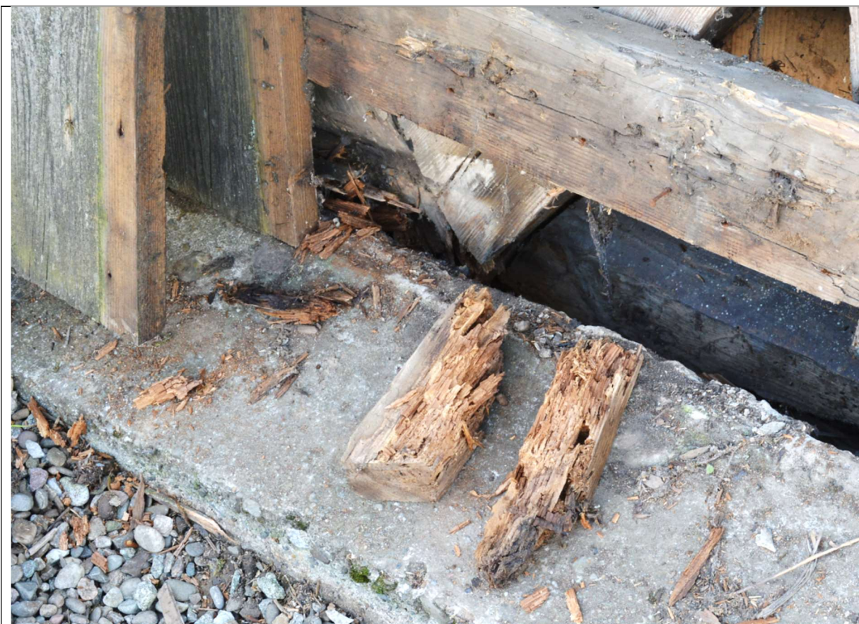
Fot. 8 Destrukcja zakrytych fragmentów zastrzalów. Wyciągnięte zniszczone fragmenty zastrzalów - odkrywka 1
