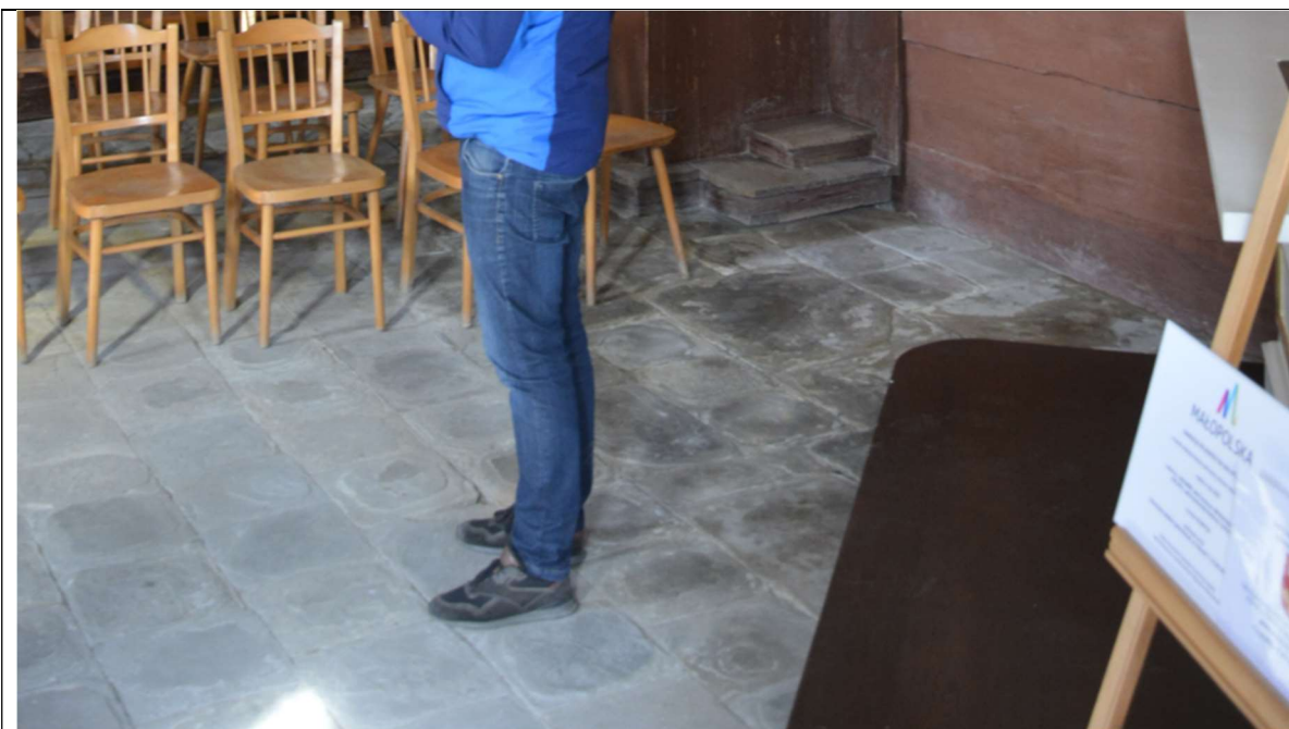
Fot. 24 Zawilgocenie posadzki nawy od strony pln
