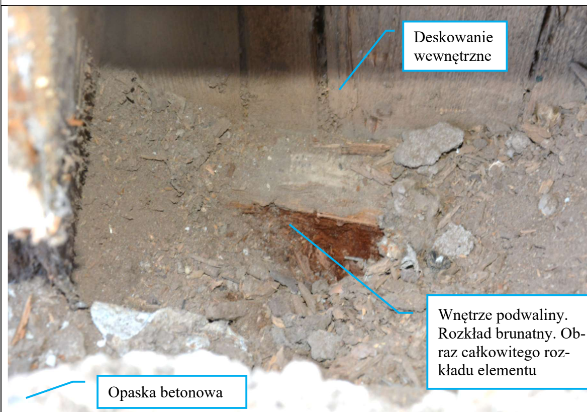
Fot. 9 Pozostałości podwaliny przy słupie ptn. Obraz zniszczenia. Całkowite zniszczenie element wskutek rozkładu brunatnego
