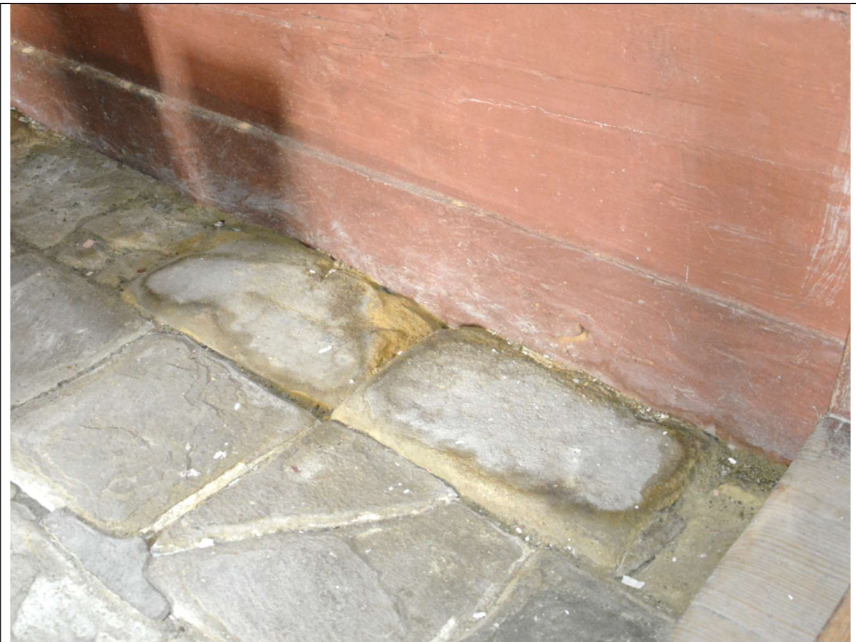
Fot. 16 Zawilgocona posadzka przy ścianie pIn
