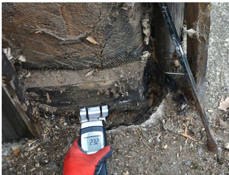
Fot. 1 Pomiar wilgotności od strony zachodniej - zewnątrz prezbiterium, 2-ga belka zrębu
